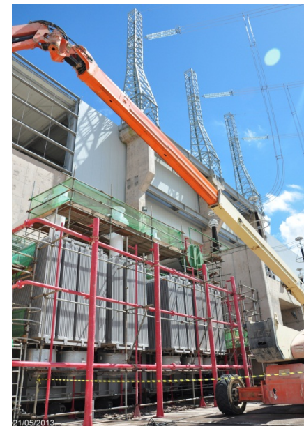
Transformador – margem esquerda
